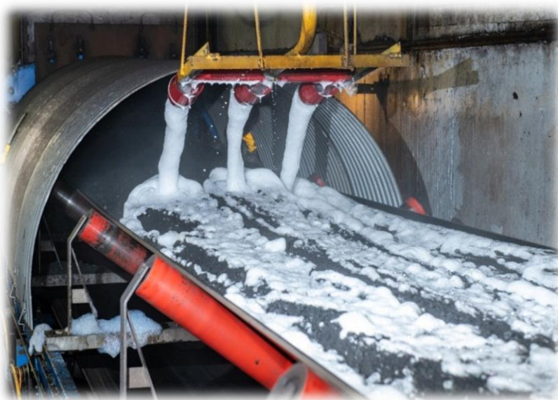
Рис. 2.5. Система пылеподавления пеной на конвейерах
